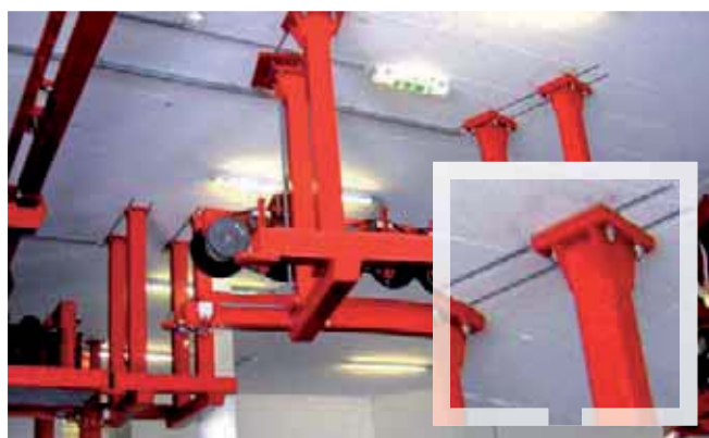
Крепление подвесной канатной дороги
