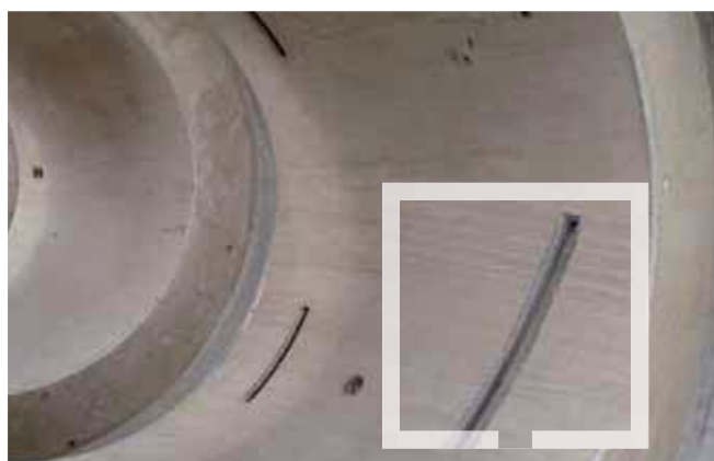
Коммуникационные трубы: Гнутые шины
